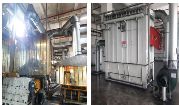
废气收集罩及储尘器
