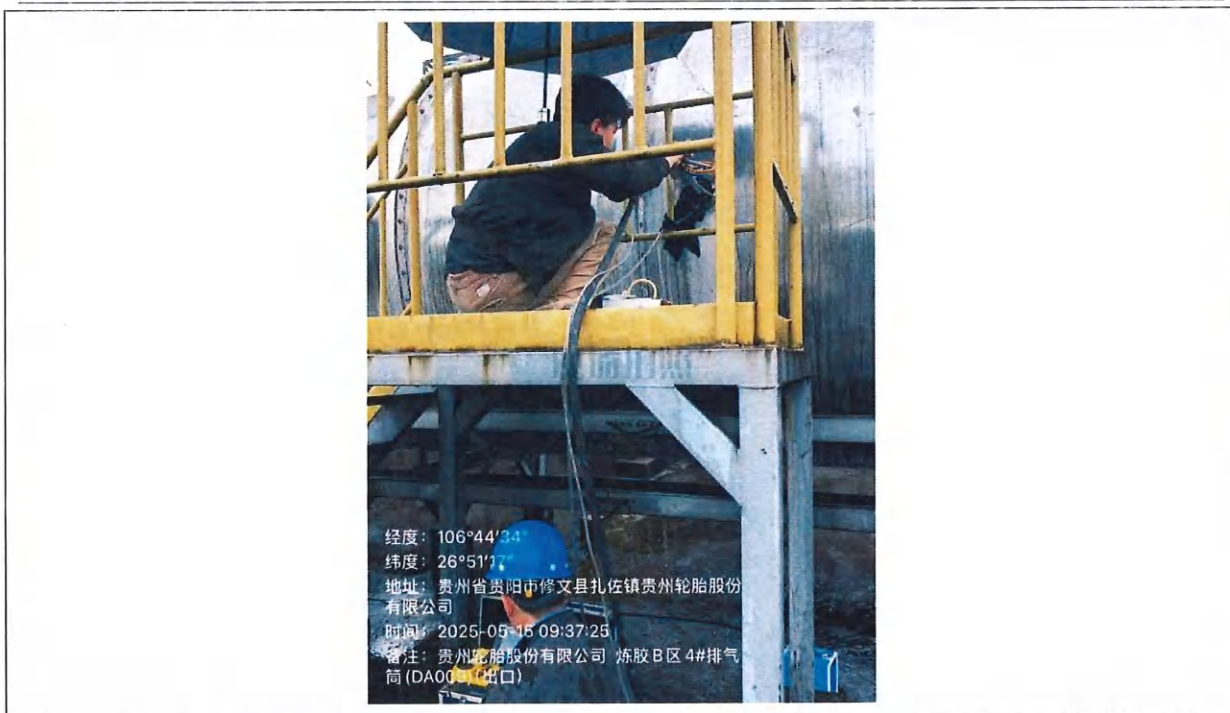
有组织废气现场检测图片（炼胶B区4#排放口(DA009)）
